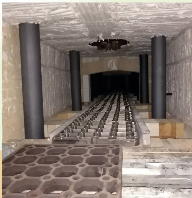
Радиационные трубы из SiSiC на автоматической линии химико-термической обработки металла ф. Aichelin (ПАО ГАЗ)
