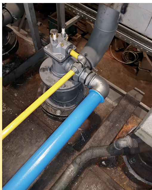
Рекуперативные газовые горелки PE-TEPM ф. Волгатерм с радиационными трубами на автоматической линии ф. Aichelin (ПАО ГАЗ)
